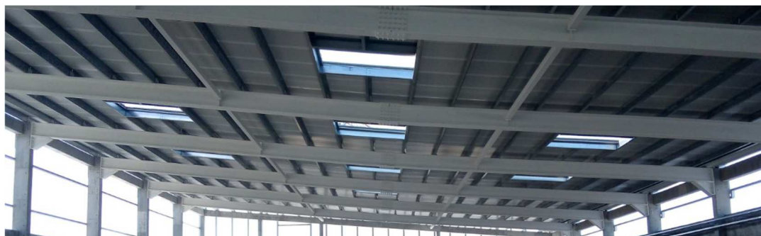
Foto 2 de 06-08-2020 da cobertura da nave principal
